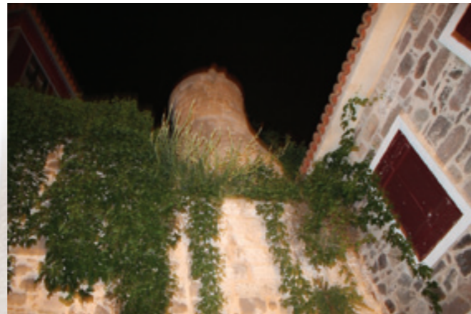
Şekil-16: Yıkılmış minarenin görünümü.
